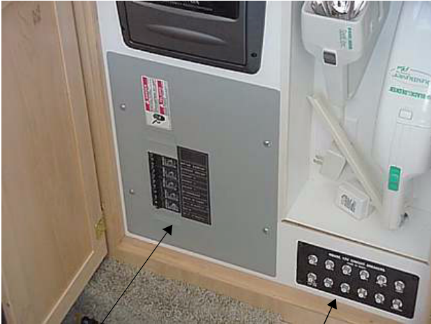
110-Volt AC Breakers
