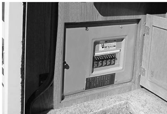
110-Volt Load Center
